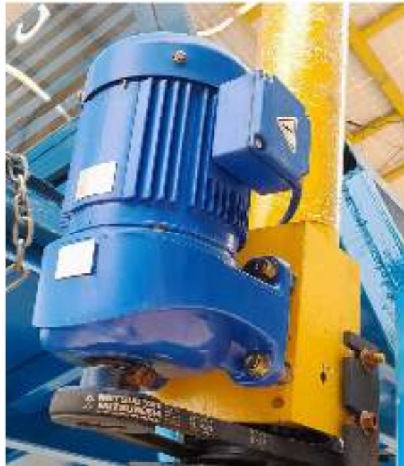
Gambar 3. 4 Motor induksi terpasang pada PLTS 10 kWp
