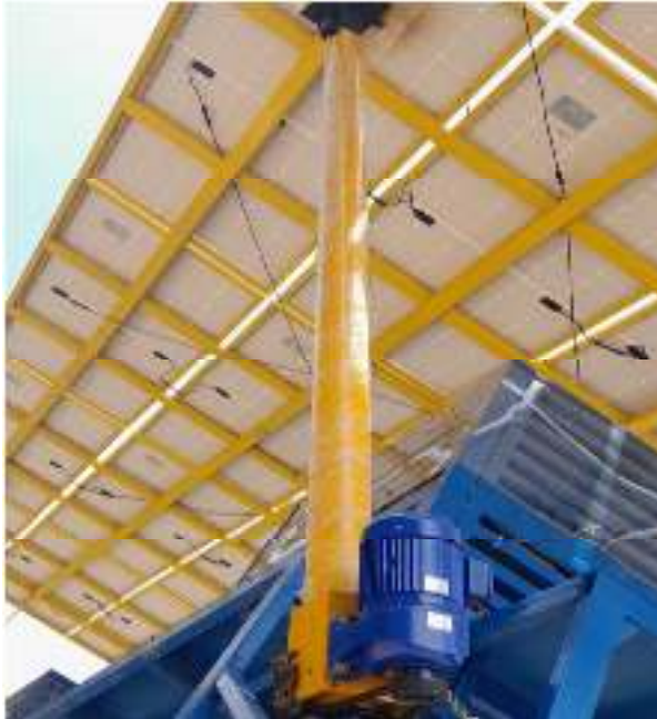
Gambar 3. 6 aktuator pada PLTS 10 kWp
