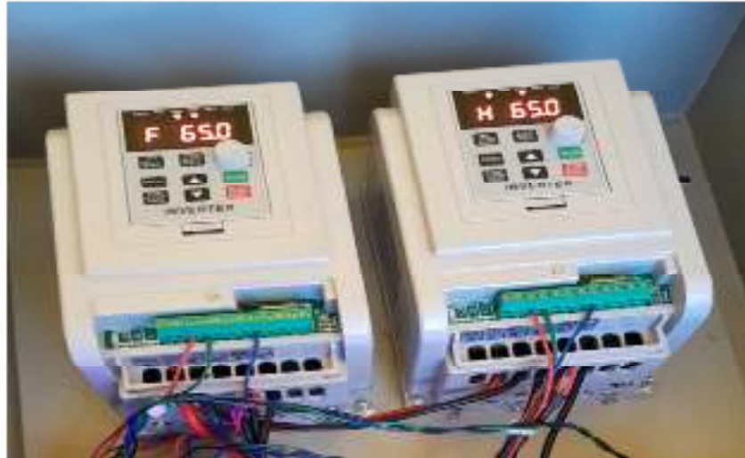
Gambar 3. 7 VFD yang di pakai pada PLTS 10 KWp UHN Medan
